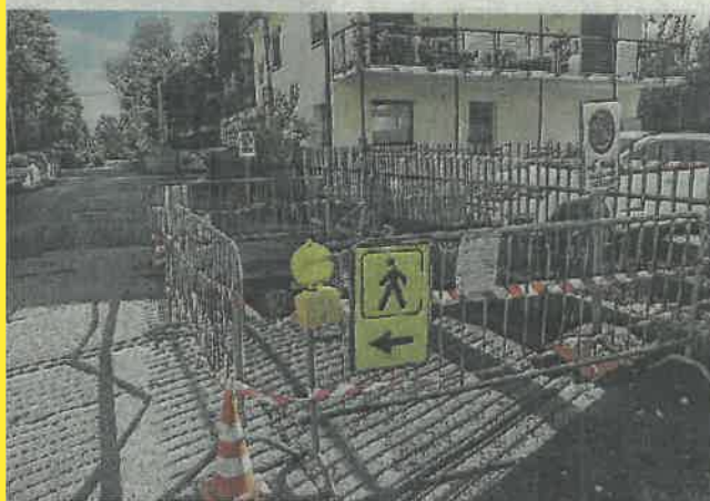
SOLO BICI E PEDONI Stop alle auto nel tratto di via Bissagola alle spalle del supermercato "Spak", dove la strada ha ceduto
